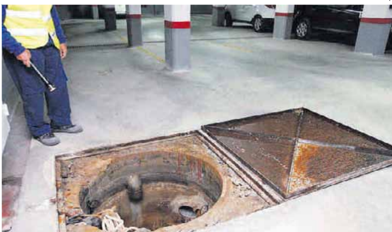
Un operario junto al pozo del acuífero, en una imagen de archivo.
