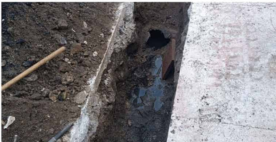
Tubería taponada en Torre del Mar / M.H.
